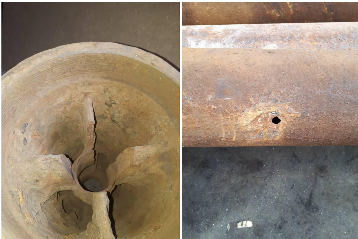
شکل شماره ۲: لوله آبده سوراخ شده بر اثر خوردگی زیاد چاه و وضعیت داخلی توربین نصب شده در چاه
