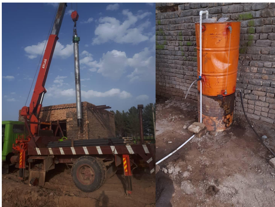
شکل شماره ۴: سیستم برگشت روغن و نصب توربین پوشش دار شده
